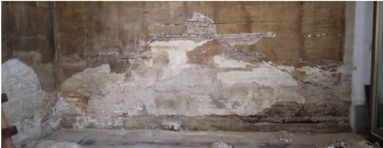
Fig. 1: quadro fessurativo parete confinante con altra u.i.u.
